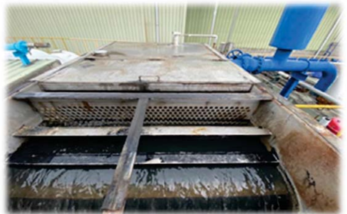
廢水處理前端槽內設有過孔阻隔
