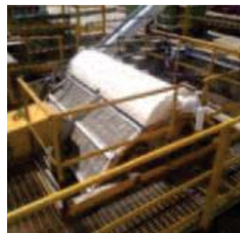
廢水處理系統設置過濾單元
