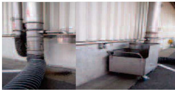
設置收集槽以捕捉管道系統中的塑膠原粒
