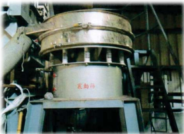
廢水處理設施前端設有震動篩
